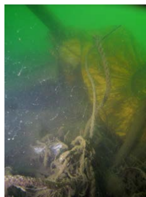
図2. 海底の水道管に絡まる筏の残骸や錨、牡蠣養殖資材など(1ヶ月後に潜って撮影)
